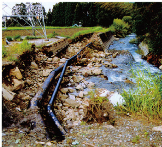
台風14号により護岸が決壊し露出した送水管
