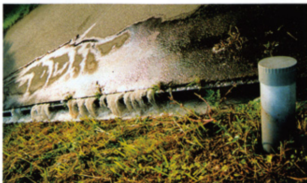
舗装面を押し上げて漏水する道路下埋設管
