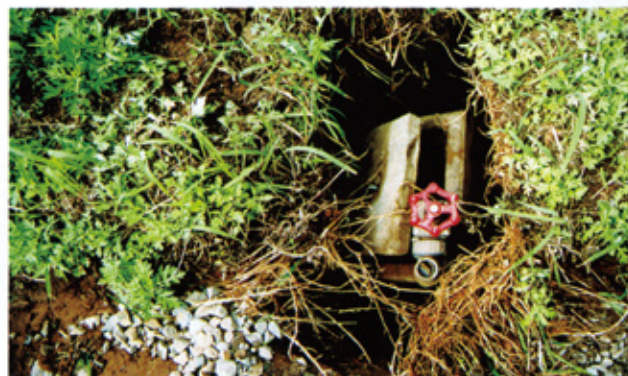
漏水により配管から脱落した給水栓
