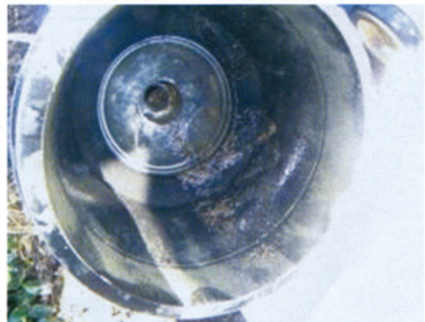
フィルターボックス内の状況
