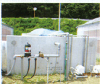
50t貯水タンク
