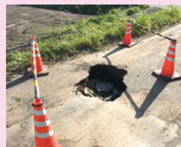
宮崎市椎屋形地区(塩ビ管接着部から漏水)
