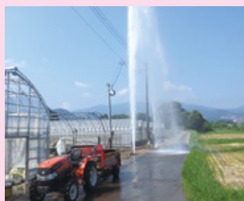
田野町地主地区(給水栓接着部から漏水)
