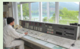
○天神ダム施設操作
